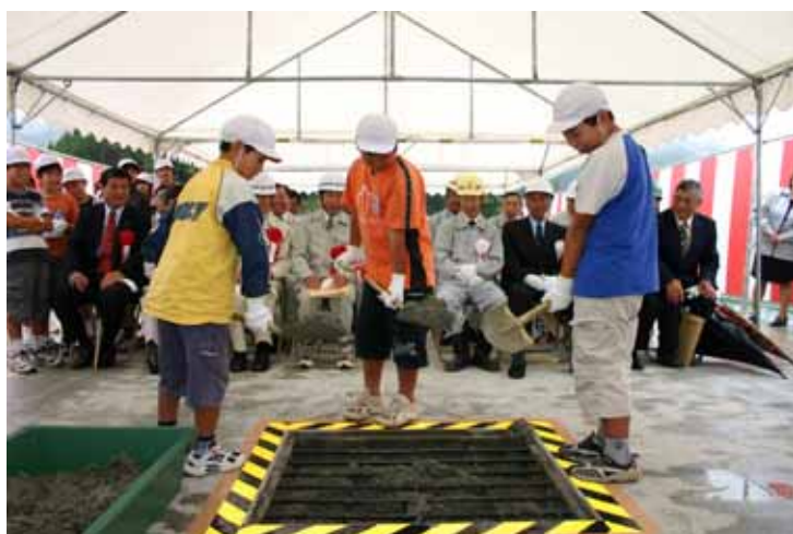
スコップで未連結部分にコンクリートを流し込む上岩戸小学校生
