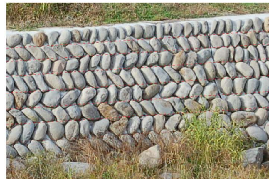
×石積みの悪い積み方例 ⇒横方向に“目”が通っており、石の積み方に規則性がある人工的な石積み
