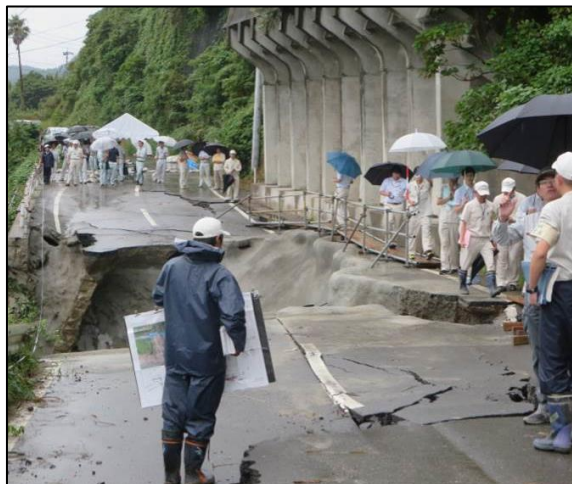
大雨により崩壊した道路の復旧
