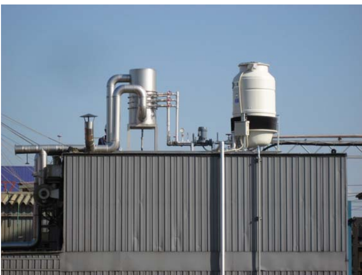
図1 稼働中の木材乾燥機に設置したスギ精油採取装置
