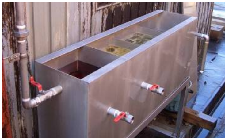
図 3 油・水分離装置の外観
