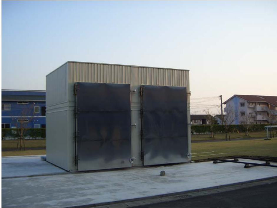
図 2 廃熱を利用した木材乾燥養生庫
