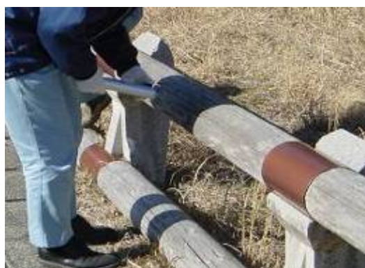
写真 3 ピロディン貫入深さ測定
