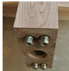
写真5 柱の割裂とLSBの引抜け破壊
