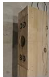
写真6 柱の中間金物によるめり込み変形
