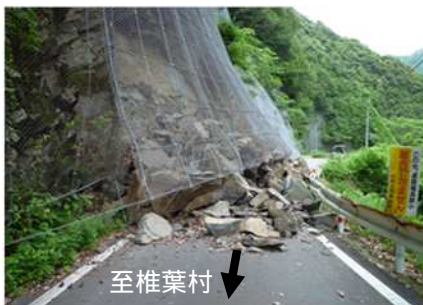
写真1 道路被災状況(H17年災)
