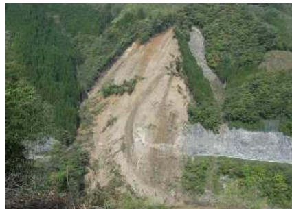
写真2 道路被災状況(H21年災)
