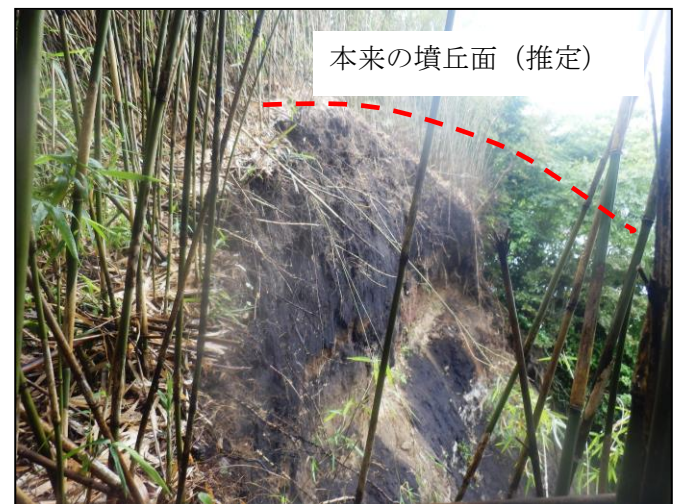
写真2 墳丘の崩壊状況（南から）
