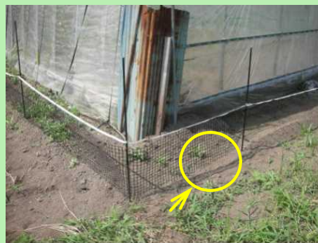
写真1：楽落くん 高さ30cm程度のプラスチックの柵の上部に電線が設置 今回は、○印の部分（柵の下側）から侵入が見られた
