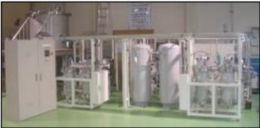
排水処理装置
