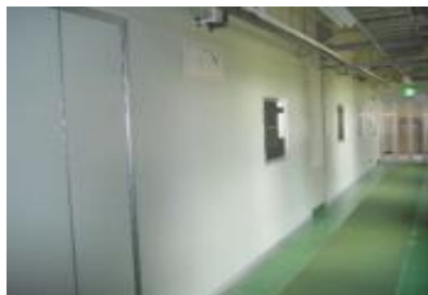
クリーンルームパネル設置例
