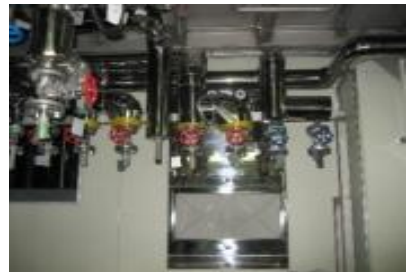
GMP空調(封じ込め)設置例
