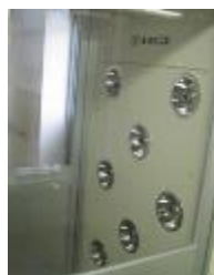
クリーンルーム内 エアシャワー
