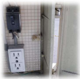
電源ボックス内
