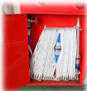
消火栓設備内
