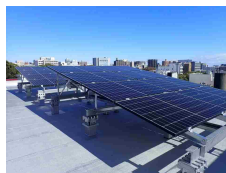
県庁7号館屋上のソーラーパネル
