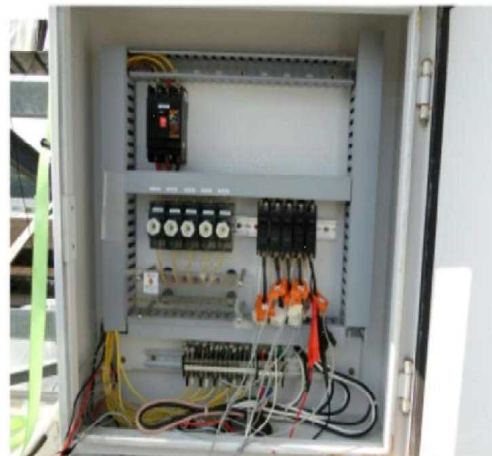
現場でのセンサ取付状況 (容易に後付け可能)
