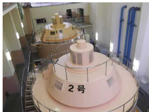
② 発電機(現状)
