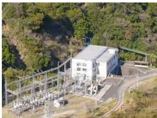
① 発電所全景(現状)
