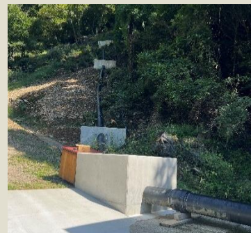
用水路から発電施設に 水を送るためのパイプ
