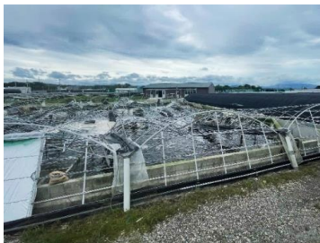
図8 突風による養殖施設の被害
