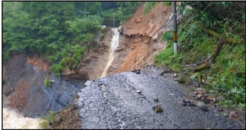
■国道388号椎葉村大河内 道路決壊
