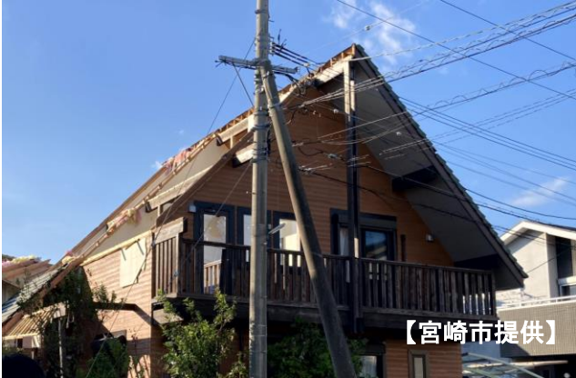
■ 突風・竜巻被害の状況
