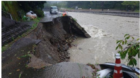
■国道388号椎葉村大河内 路肩決壊
