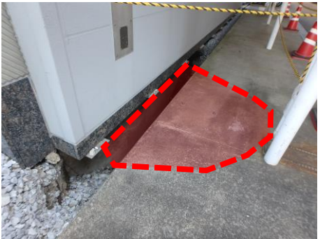
■ 企業局庁舎周囲地面陥没
