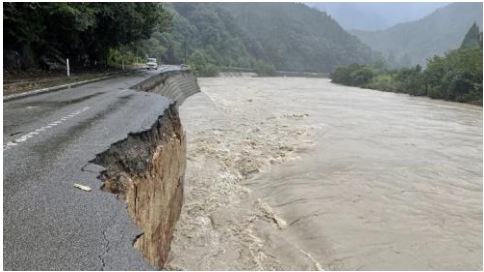
■国道446号日向市東郷町 路肩決壊
