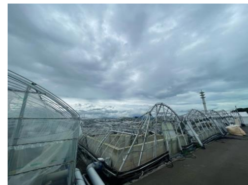
■養鰻施設の被害
