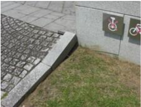
■ タイルの割れ・浮き （県立美術館）
