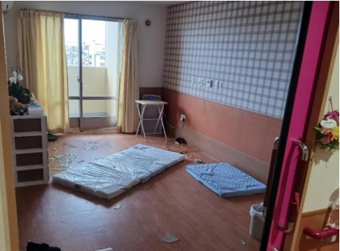
■福祉施設の建物被害
