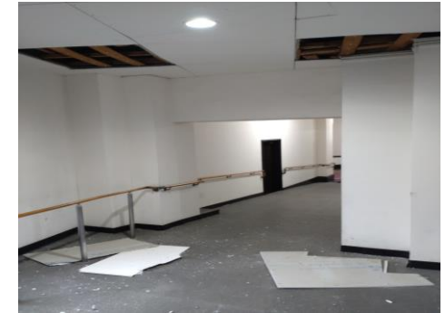
■ 県庁舎通路の被害
