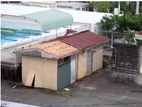
■被害の写真 （プール付属室）
