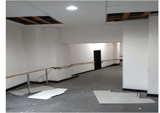
■ 県庁舎通路の被害
