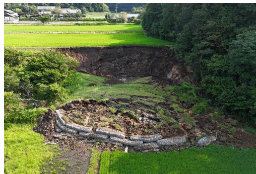
■農地（水田）の崩壊と 水路の埋没
