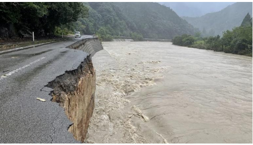
■国道446号日向市東郷町 路肩決壊
