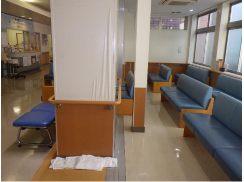
■病院局の被害（雨漏り）
