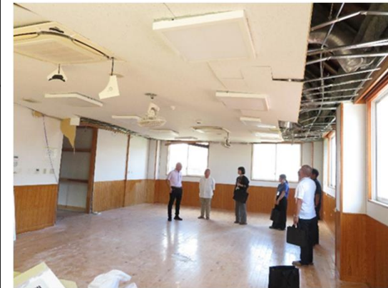
認定こども園の被害状況 (日南市)
