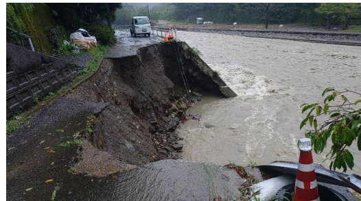
■国道388号椎葉村大河内 路肩決壊
