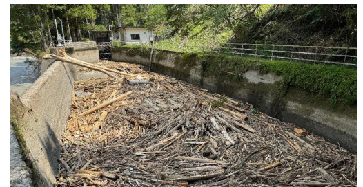
■取水堰流木堆積
