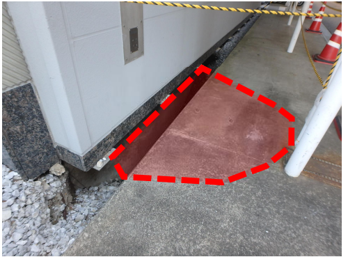
■企業局庁舎周囲地面陥没
