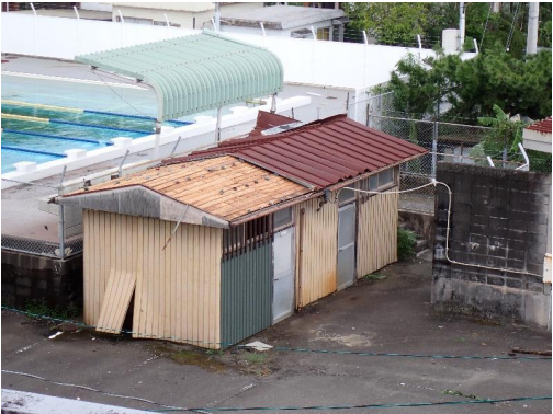
■被害の写真 (プール付属室)
