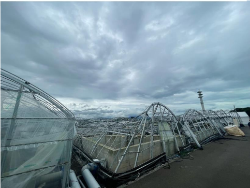
■養鰻施設の被害
