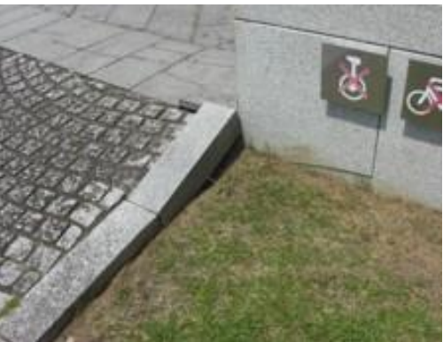
■タイルの割れ・浮き (県立美術館)
