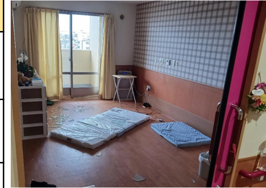
■福祉施設の建物被害
