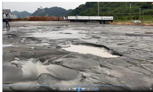
■油津港 日南市油津 荷捌き地 液状化現象
