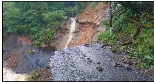
■国道388号椎葉村大河内 道路決壊
