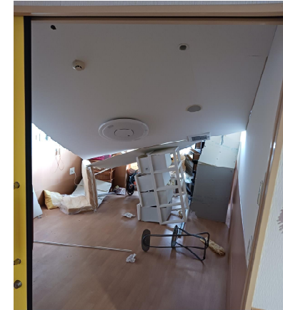
■特別養護老人ホームの 天井の破損 (宮崎市)
