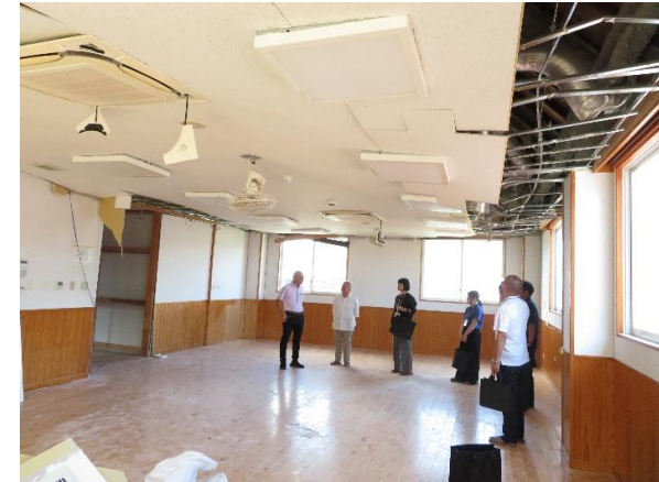
■認定こども園の天井の破損（日南市）
