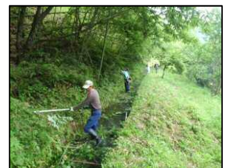
山腹水路の維持管理状況
