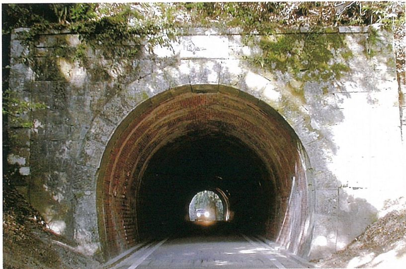
本県で初のれんが張りのトンネル。文化遺産としても貴重
