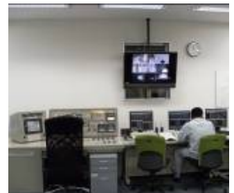
管理・制御室
