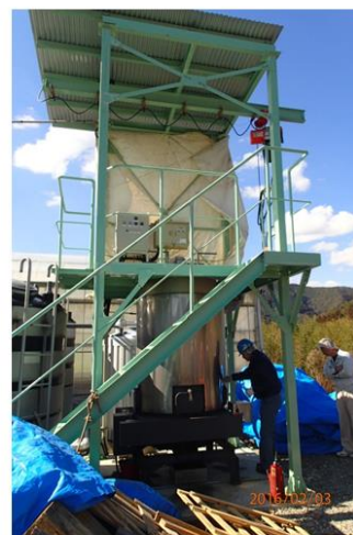
図2 野菜工場用温水ボイラー
