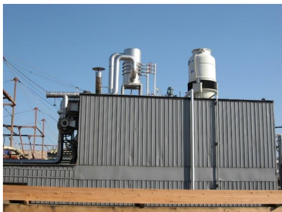
図3 木材乾燥機に設置した精油回収装置
