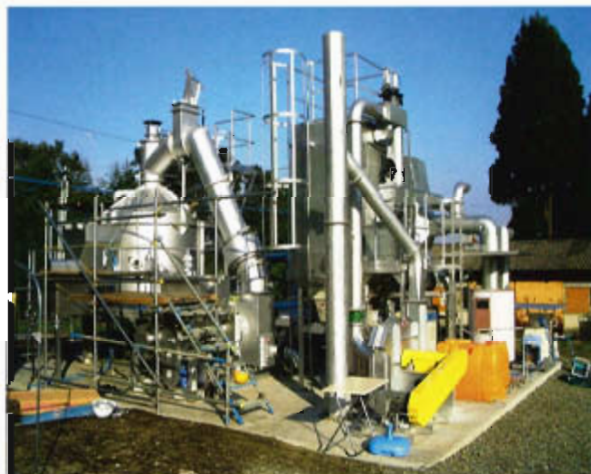
畜産試験場内に設置されたパイロットプラント
