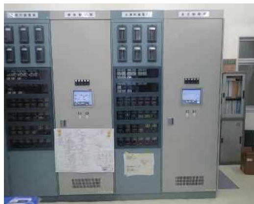
新しい自動制御盤と既設の保護継電器盤
