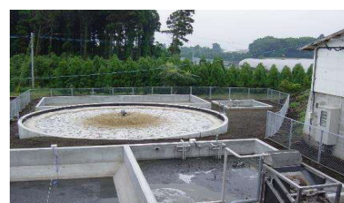
2-(1) 汚水処理施設
