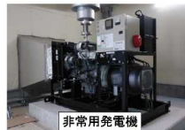
非常用発電機
