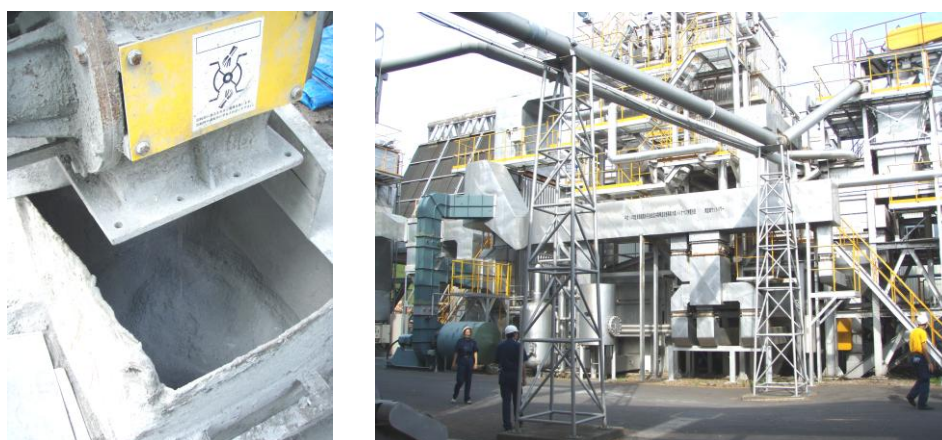
燃焼灰と木質燃焼プラント
