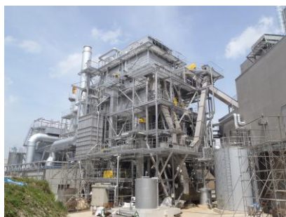
図19 畜ふん燃焼発電施設
