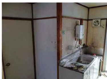
【壁】木材、石綿板が使用されている
