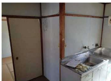
【壁】木材、石綿板が使用されている
