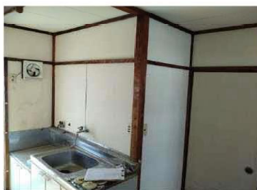
【壁】木材、石綿板が使用されている
