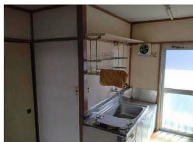
【壁】木材、石綿板が使用されている
