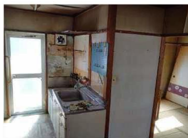
【壁】木材、石綿板が使用されている
