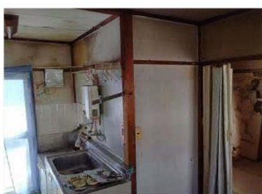
【壁】木材、石綿板が使用されている
