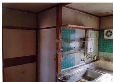
【壁】木材、石綿板が使用されている
