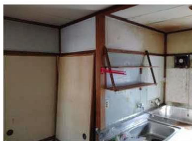
【壁】木材、石綿板が使用されている
