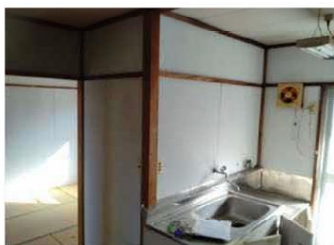
【壁】木材、石綿板が使用されている
