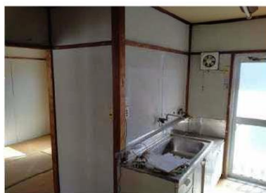
【壁】木材、石綿板が使用されている
