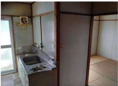
【壁】木材、石綿板が使用されている
