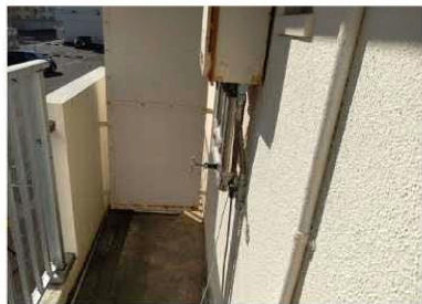
【壁】吹付タイル、隔壁板が使用されている
