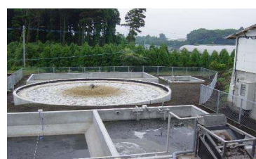
2-(1) 汚水処理施設
