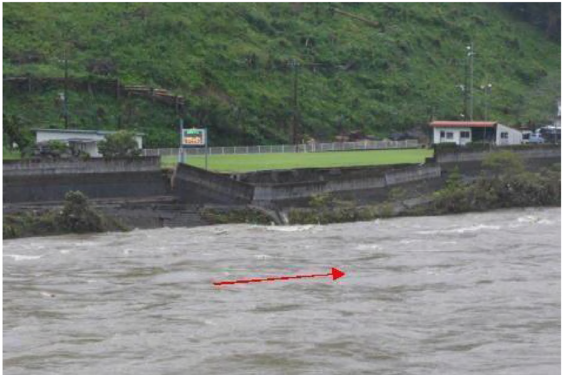
<令和4年9月 台風14号による護岸被災状況（大淀川：高岡町片前地区）>
