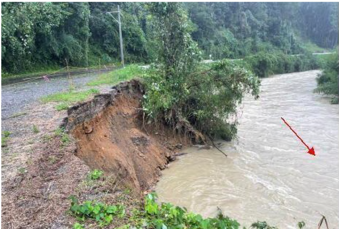
<令和4年9月 台風14号による護岸被災状況（浦之名川：高岡町平木場地区）>
