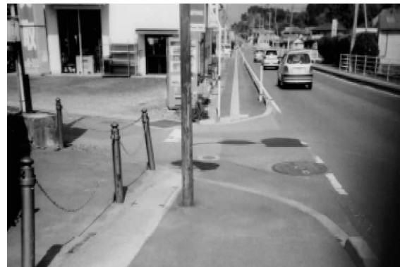
根元が腐食している状況
