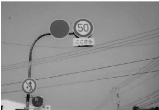
標識板設置部分が錆びている状況
