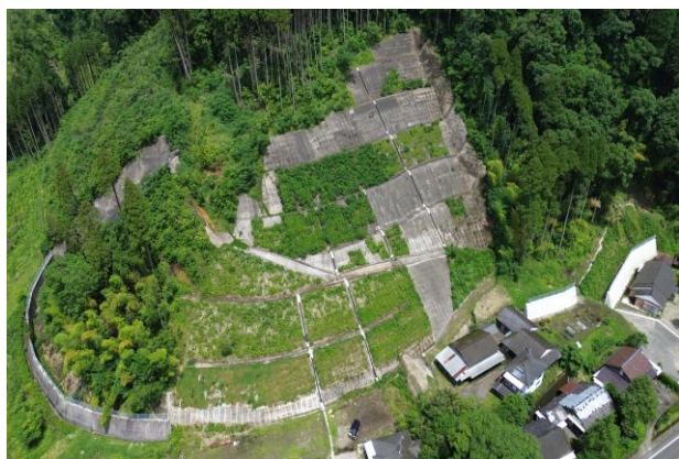
西牛ノ脛地区 急傾斜地
