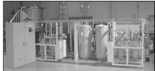
排水処理装置
