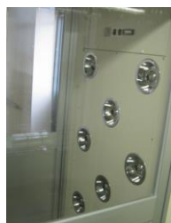
クリーンルーム内 エアシャワー
