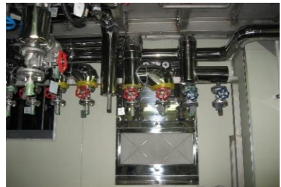
GMP空調(封じ込め)設置例
