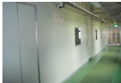
クリーンルームパネル設置例
