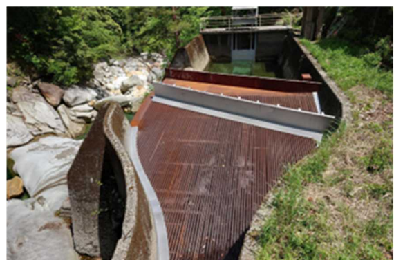
上祝子取水設備
