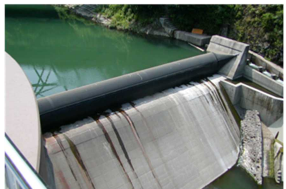
ゴム引布製起伏堰
