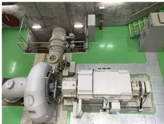
酒谷発電所水車発電機
