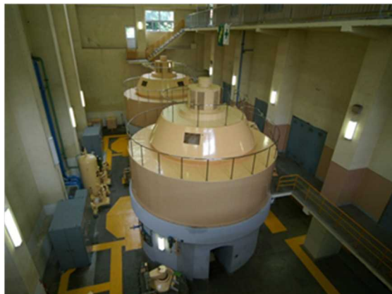
綾第二発電所発電機
