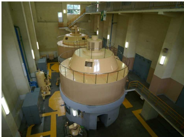
既設水車発電機
