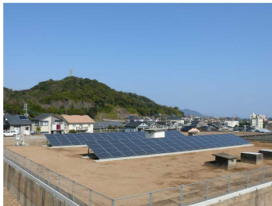
工業用水道施設配水池太陽光発電設備
