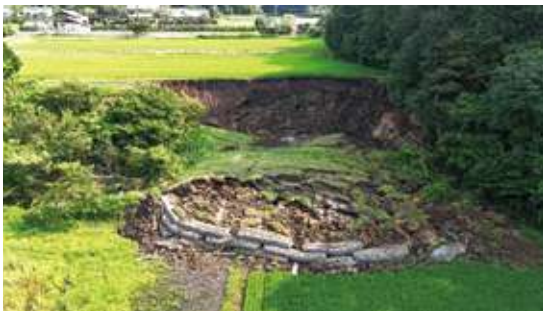
＜地震による被害状況＞
