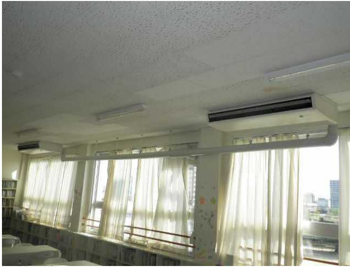
空調整備後の特別教室（岡富小学校）
