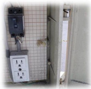
電源ボックス内
