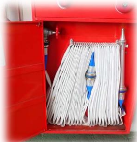
消火栓設備内
