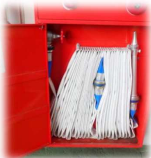
消火栓設備内
