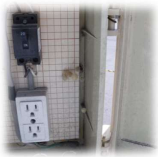
電源ボックス内
