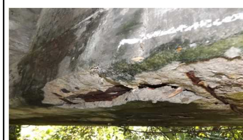
橋梁の老朽化対策（剥離・鉄筋露出）
