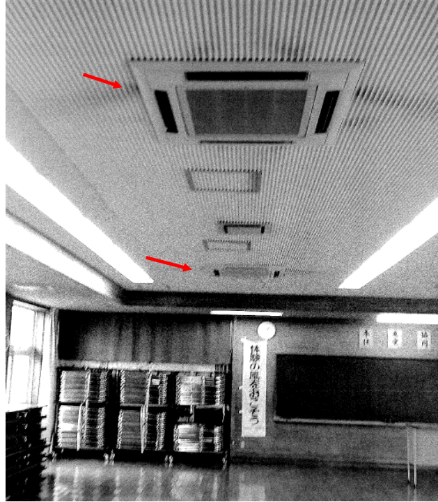
創作工芸館空調機（室内機）
