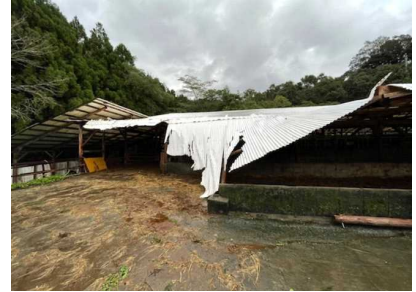
畜舎の損壊（美郷町）
