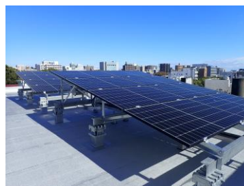
県庁7号館屋上のソーラーパネル
